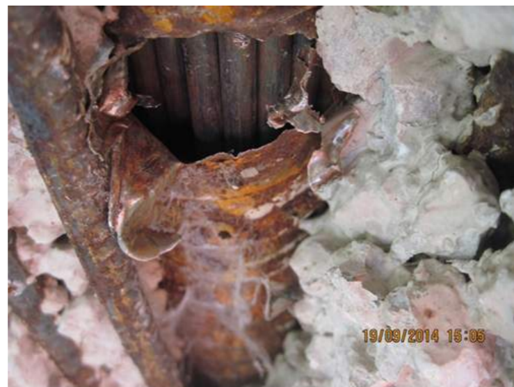
Fig. 26 - Ispezione in guaina corrugata metallica in una trave da ponte: si nota la suddetta guaina non iniettata e i cavi in trazione (detensionati) con segni di corrosione sotto sforzo - Rif. Lucia Rosaria Mecca
