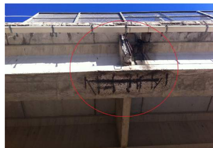
Fig. 21 - Effetti della carbonatazione: esempio tipico di corrosione "diffusa" delle barre di armatura in una trave da ponte – Rif. Lucia Rosaria Mecca
