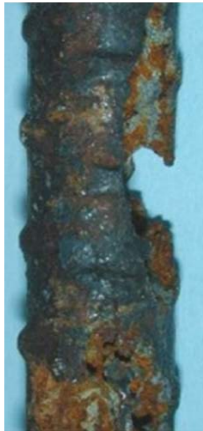
Fig. 24 - Effetto dei cloruri: esempio tipico di corrosione "localizzata" delle barre di armatura - Pietro Pedefferri
