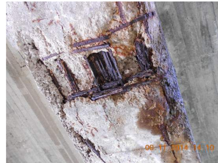
Fig. 27 - Ispezione in guaina corrugata metallica in una trave da ponte: si nota la suddetta guaina non iniettata e i cavi in trazione con segni di corrosione sotto sforzo - Rif. Lucia Rosaria Mecca
