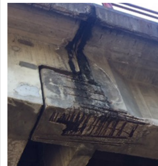
Fig. 23 - Degrado in corrispondenza della sella Gerber
